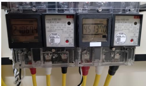
設置場所①(電気)
